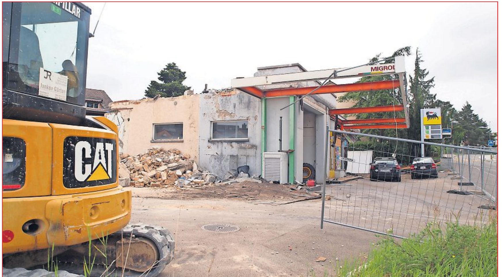
Täglich ist etwas weniger übrig von den alten Gebäuden an der Glattalstrasse 175, wo ein neues Aparthotel entstehen soll. Fotos: Sabine Schneiter
